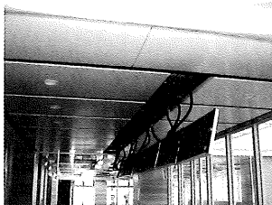
日本大学法学部図書館の放射冷暖房パネル
